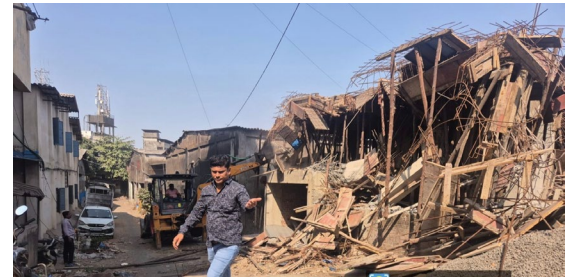
सुनील भोईर, अपने कार्य क्षेत्र में, नारपोली-2, मकान नंबर 853/0, सीताराम पाटिल के भवन के बगल में, नारपोली-2, भिवंडी, आरसीसी ग्राउंड फ्लोर के लिए अनाधिकृत रूप से सेंट्रिंग के निर्माण पर जेसीबी द्वारा कार्रवाई की गई।
